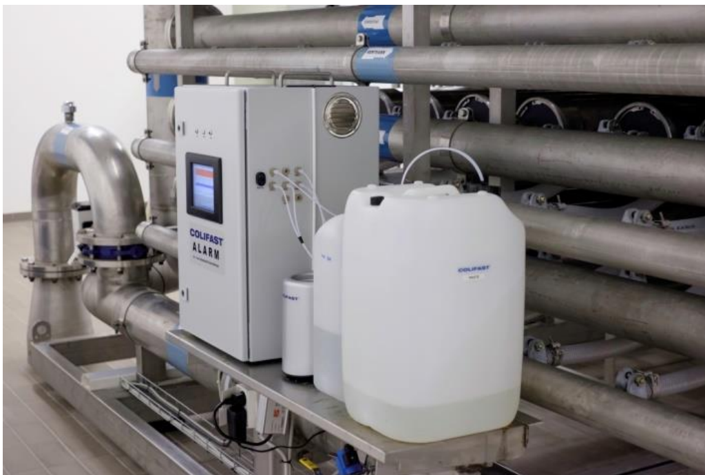
El Colifast ALARM monitoreando el agua potable producido en una planta potabilizadora de agua
